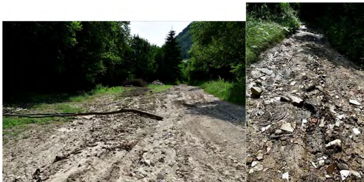
Obr. č. 28: Prejavy výmoľovej erózie na lesných cestách v obvode PPÚ Prečín (2021)
